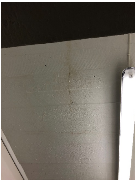
Fukt utslag i tak og vegg
